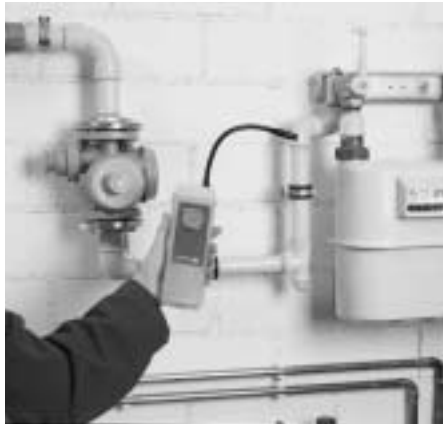
Abb. 32: Lecksuche an Gasleitungen mit dem testo 316
