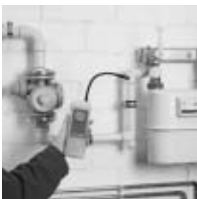
66 Gaslecksuche mit testo 316
